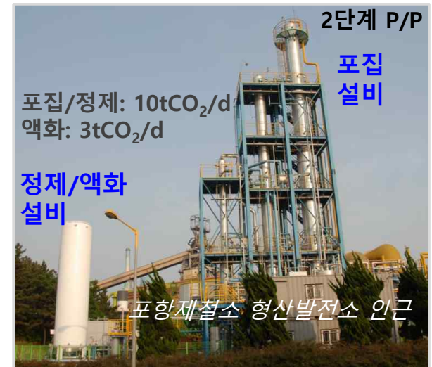
[1.0 kNm 3 /hr CO 2 포집/정제/액화 설비]
