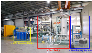
[CO2 액화기초실험 Test Facility 구성]
